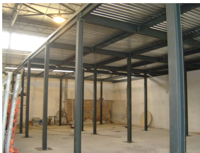
Figura 1 – Strutture nuovi laboratori all'interno di locali esistenti
