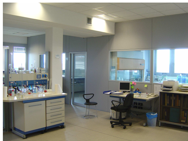
Foto 2 – Laboratori in uso, con canale d’aria nascosto a trave senza passaggi nel controsoffitto
